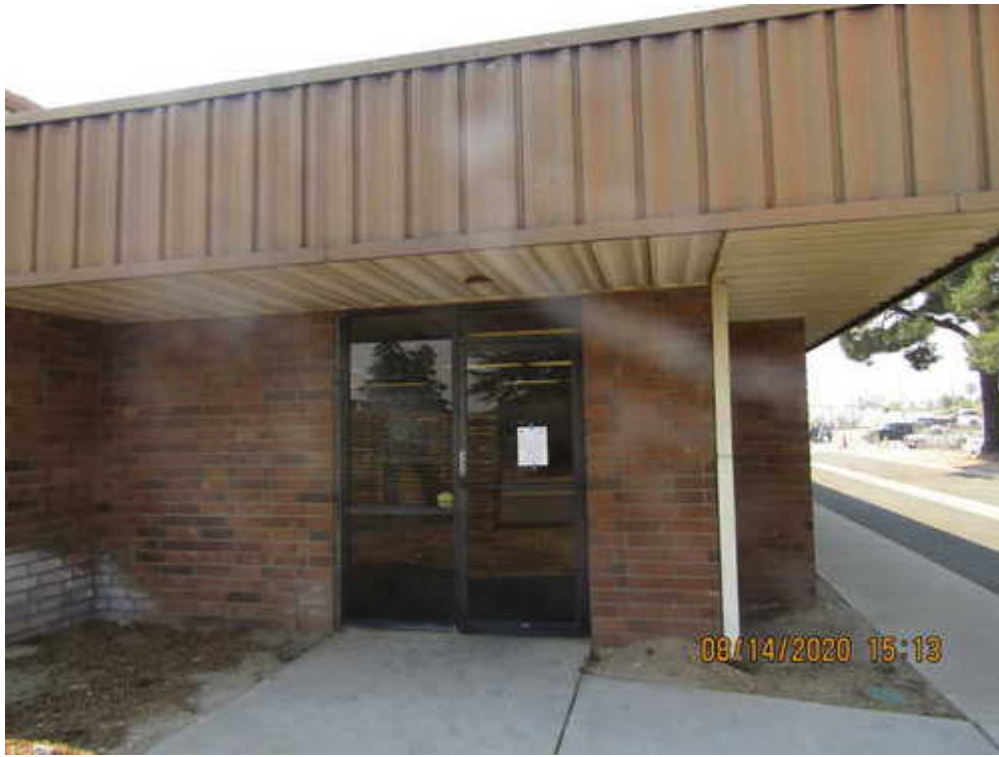
5770 Industrial Pkwy - Posted NOV (3).JPG
